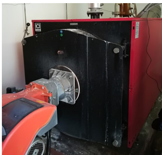
Figura 4.10 - Particolare della caldaia ICI Caldaie Rex 75
