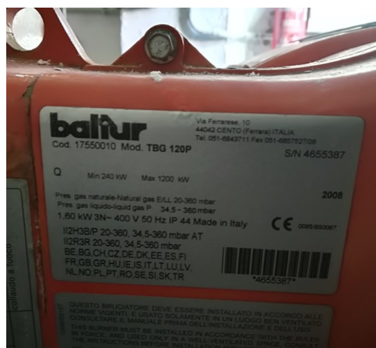
Figura 4.11 - Particolare del bruciatore Baltur TBG 120P
