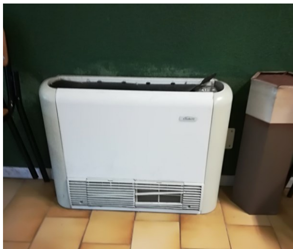
Figura 4.5 – Particolare dei ventilconvettori installati nell'atrio centrale posta al primo piano interrato
