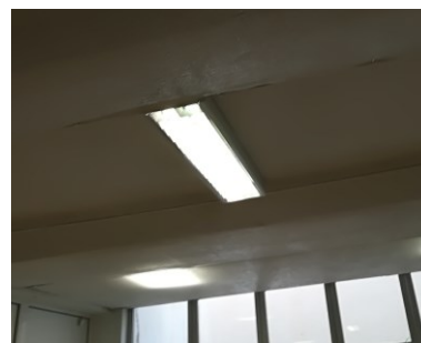
Figura 8.11 - Particolare di una lampada fluorescente attualmente installata
